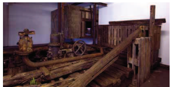
Izaak Zwartjes: SA-1. Generator System Pump, 2013. ▶ Foto: Jhoeko
